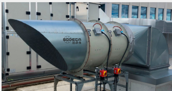
DESPRESSURIZAÇÃO DE ESCADAS Penrose Dock, Irlanda
