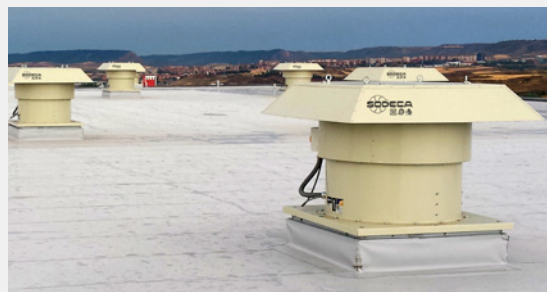
EXAUSTÃO DE FUMOS Silo Inditex, Madrid
