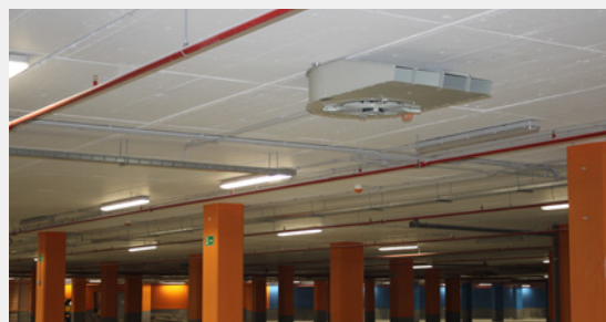
VENTILAÇÃO DE PARQUES DE ESTACIONAMENTO Centro comercial Madrid RIO, Espanha
