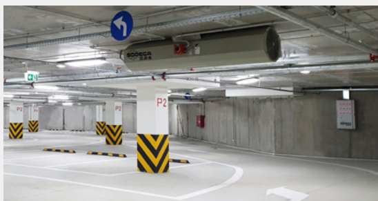
VENTILAÇÃO DE PARQUES DE ESTACIONAMENTO Hotel Sheraton Grand Tbilisi Palace, Georgia
